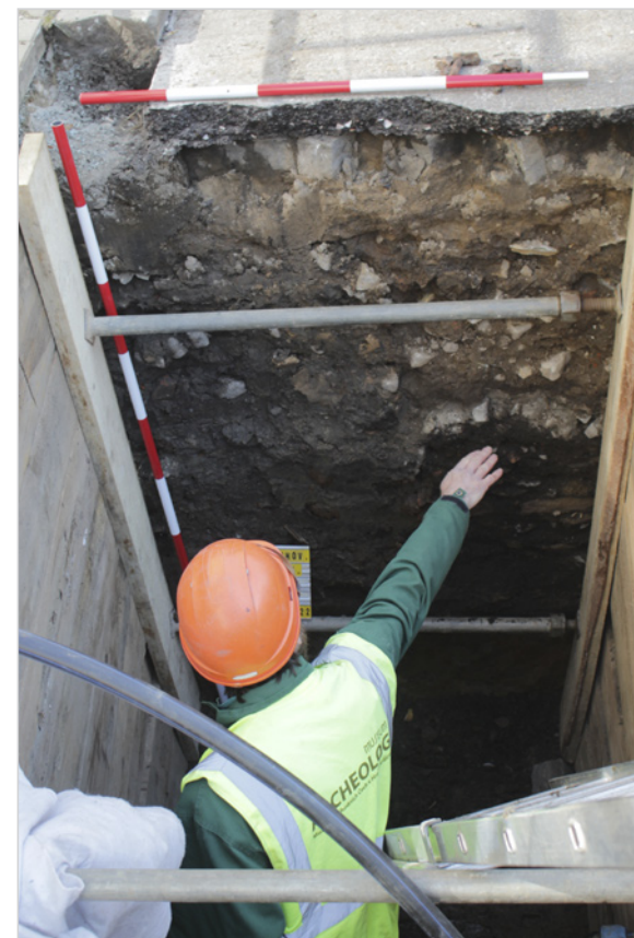
Třebechovice pod Orebem, vodovod
