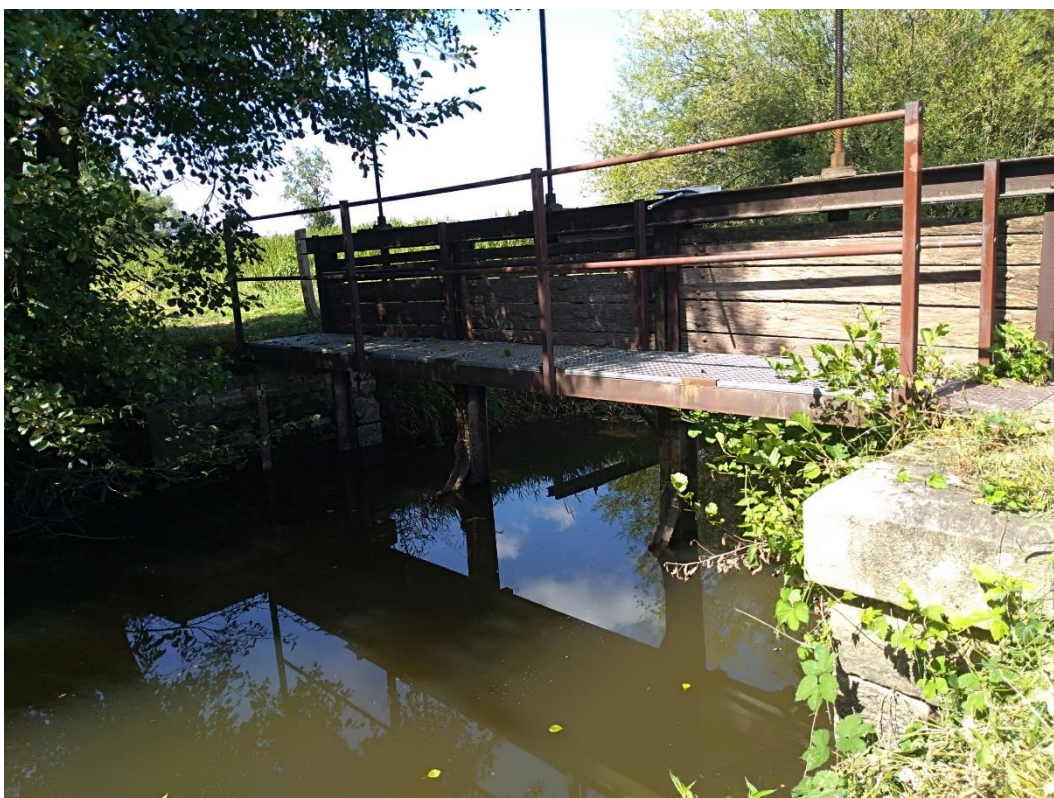
Foto č. 6 – Jez – Stará Metuje II. – 2,170 (2,070) ř. km
